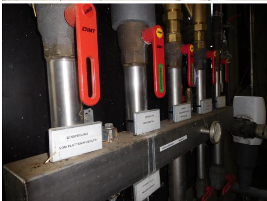
Wasserverbrauchsmesser (Foto: Harms)
