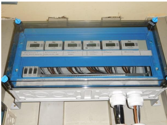
Stromzähler (Foto: Harms)
